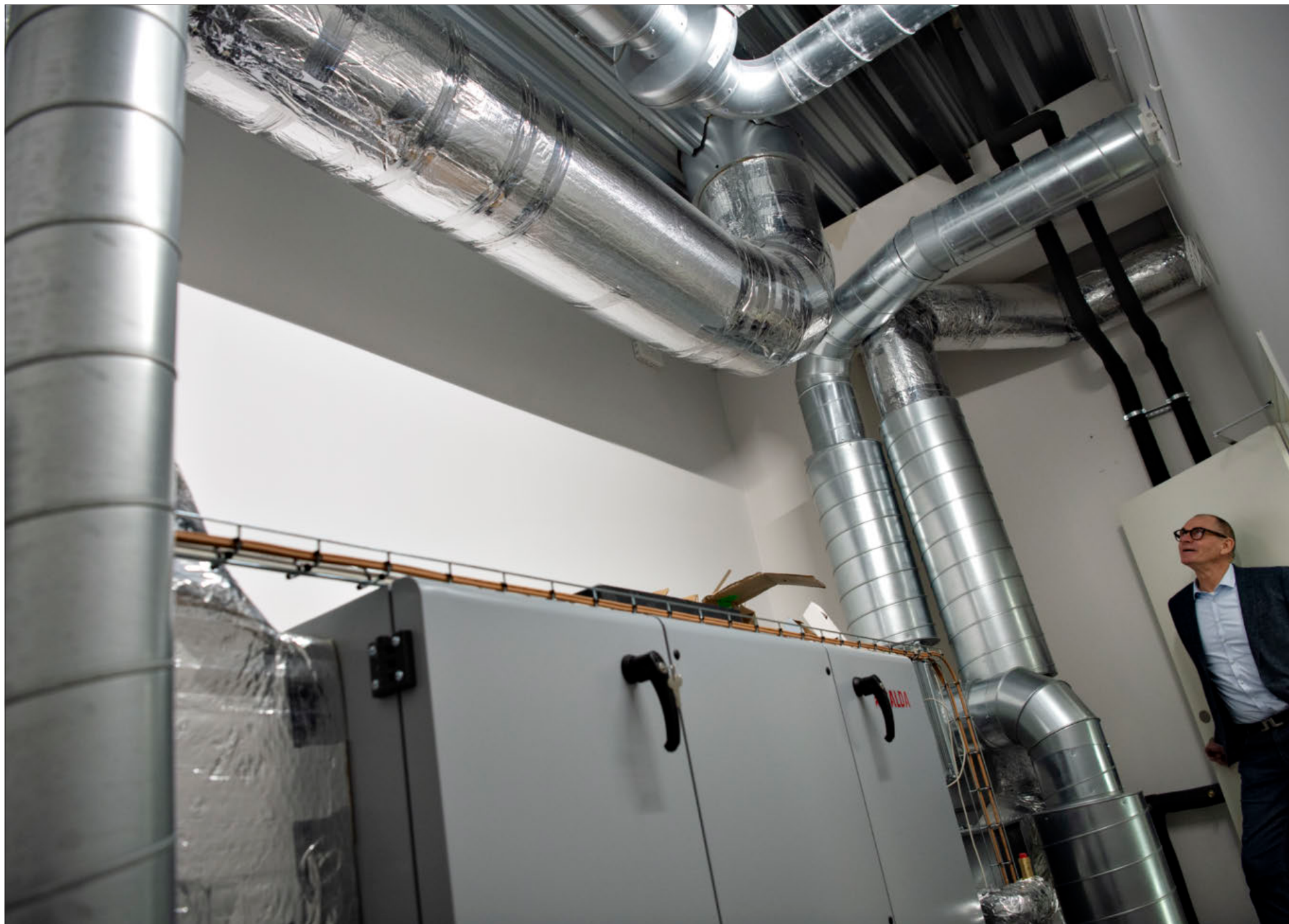
Måske et lidt vel stort ventilationsanlæg til et nybygget kontor- og lagerdomicil på knap 1.000 kvm. Men det hører sig til, når man som Simas Filters A/S lever af at sælge filtre til andre virksomheders ventilationsanlæg, siger bestyrelsesformand Hans Christian Bech Thøgersen. Fotos: Brian Karmark
